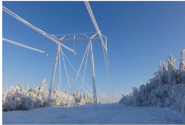
Рисунок 2.1 – ВЛ-500 кВ с расщепленными проводами
