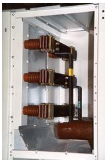
Рис. 7.3. Отсек сборных магистральных шин
