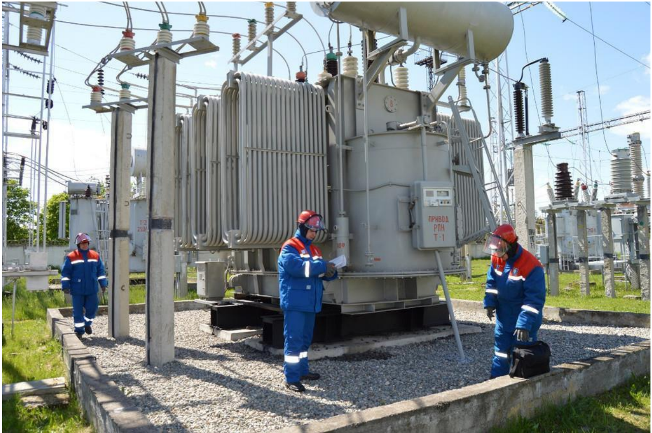
Рисунок 2. Осмотр подстанций 110-35 кВ.
