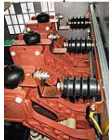
Рисунок 2.8.10 - Нелинейные ограничители перенапряжений, Для защиты оборудования от коммутационных и грозовых перенапряжений в цепи силовых выключателей устанавливаются
