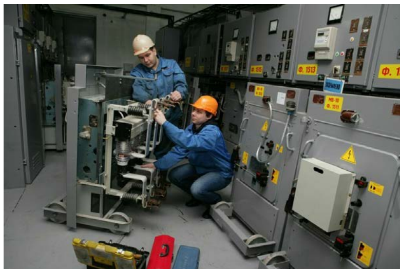
Рисунок 2 – Проверка оборудования КРУ
