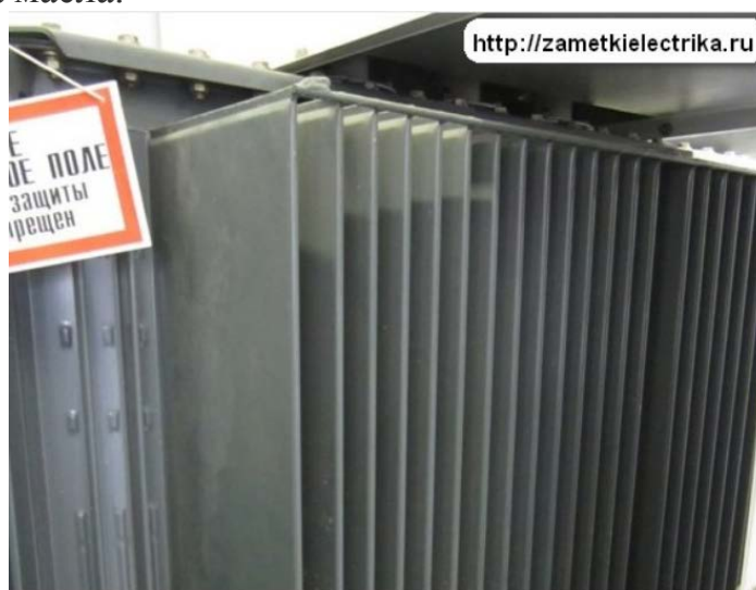
Рисунок 21 – Трансформатор типа ТМГ11
