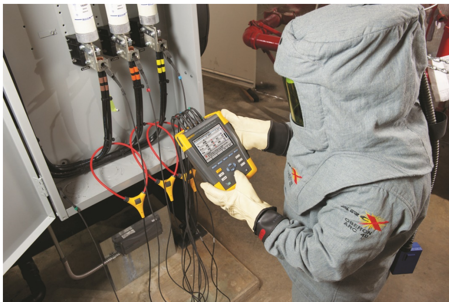
Рисунок 7 – Проведение испытаний КРУ
