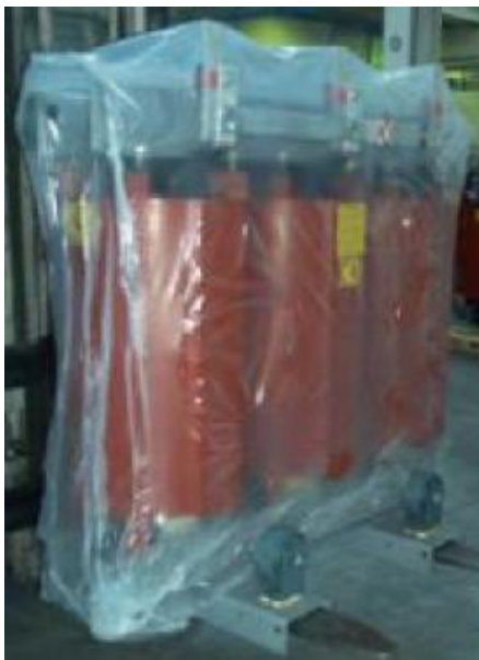
Рисунок 7 – Хранение сухого трансформатора в полиэтиленовой пленке
