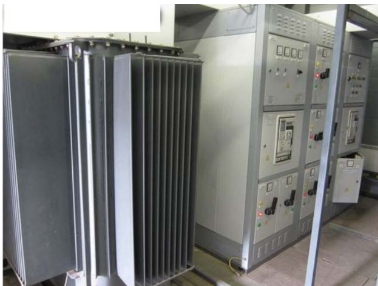
Рисунок 20 – Трансформатор типа ТМГ11
