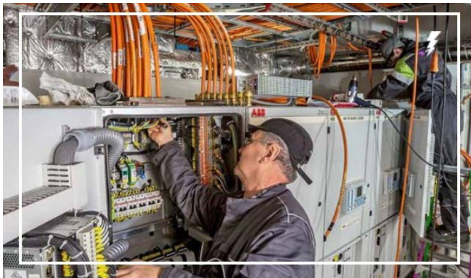
Наладка и обслуживание КРУН
