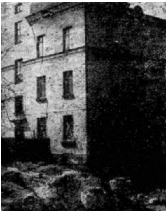
Рисунок 3 - Здание, получившее аварийные повреждения в результате забивки свай в соседнем строительном котловане (фото 1979 г.)
