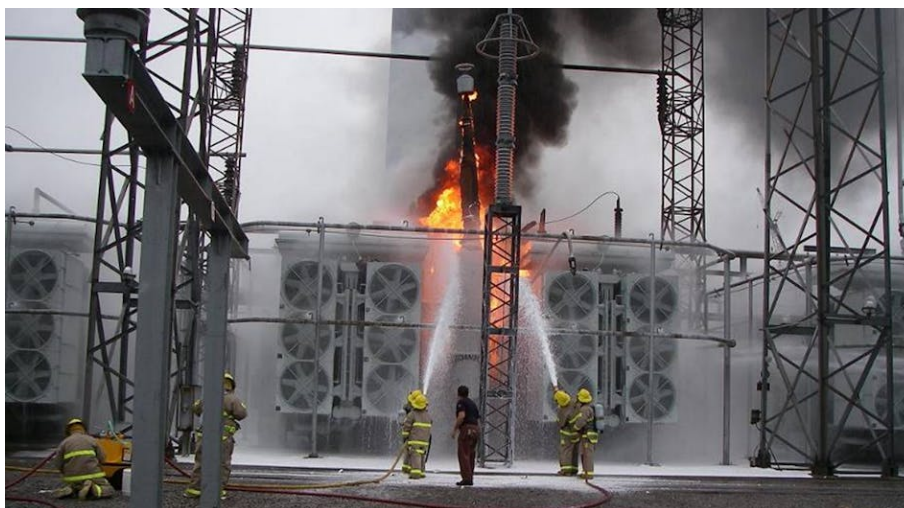
Рисунок 14 – Последствия халатного монтажа и наладки ввода
