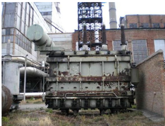
Рисунок 6 – Силовой трансформатор со следами коррозии
