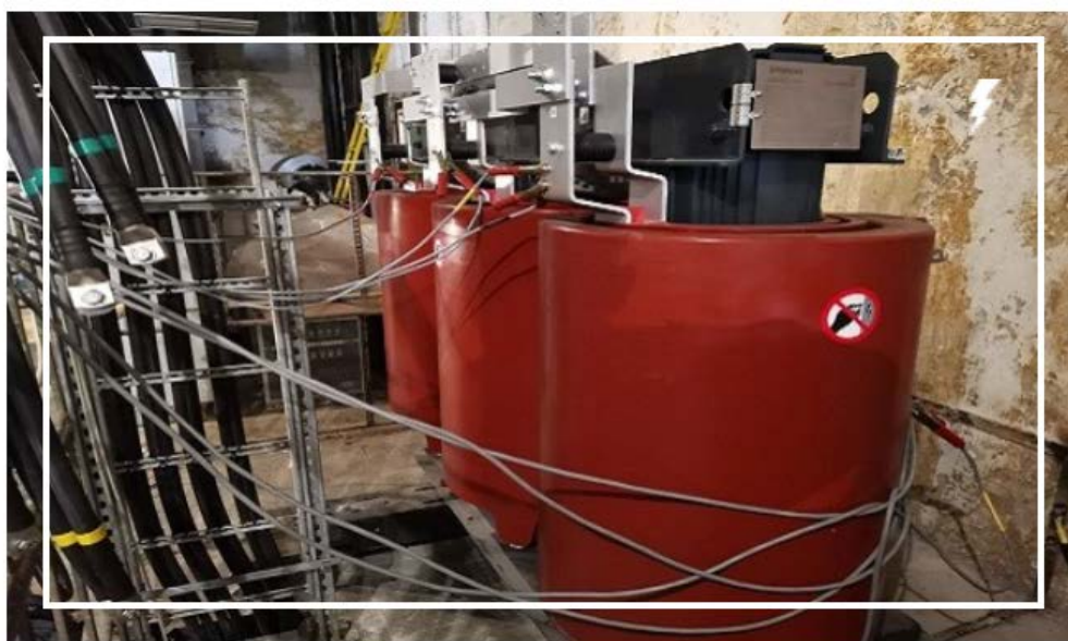
Исследование рабочих характеристик и проверка состояния силового оборудования КРУН
