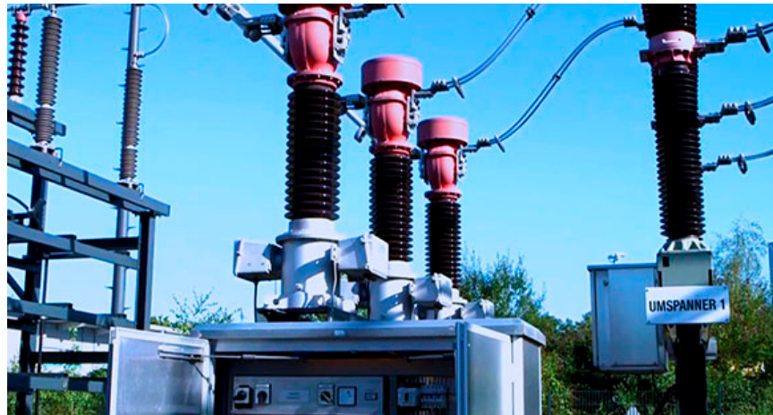
Рисунок 4 – Проверка и наладка работы высоковольтных измерительных трансформаторов
