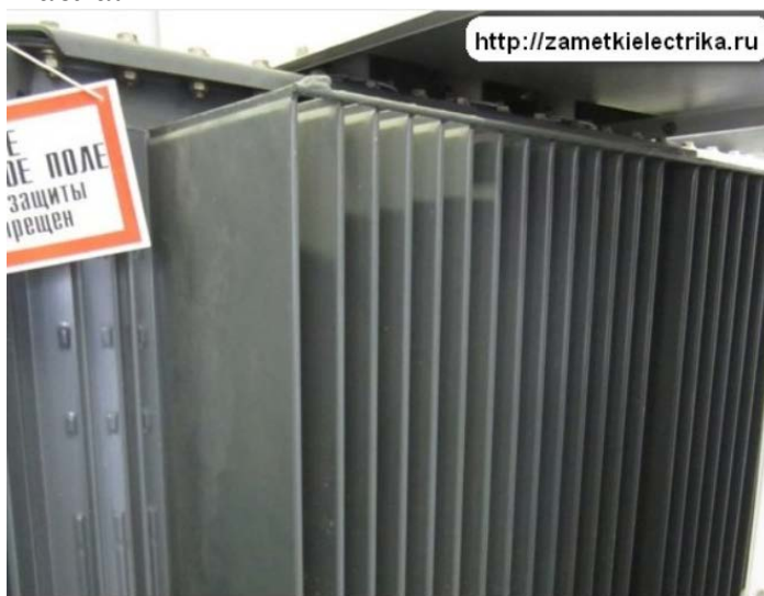
Рисунок 21 – Трансформатор типа ТМГ11
