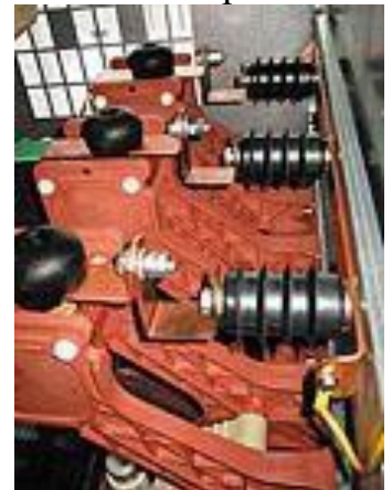
Рисунок 2.8.10 - Нелинейные ограничители перенапряжений, Для защиты оборудования от коммутационных и грозовых перенапряжений в цепи силовых выключателей устанавливаются
