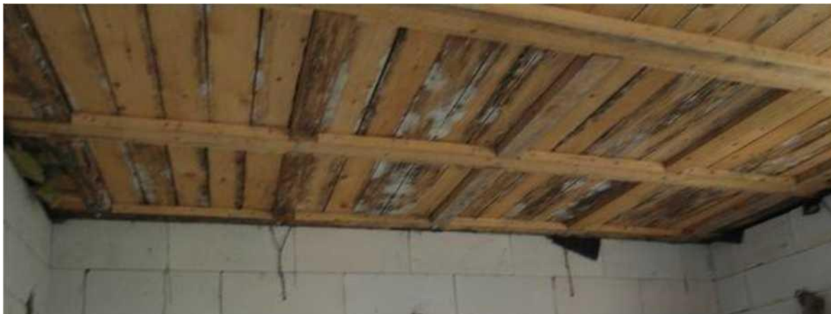
Рис. 2.1. Перекрытия по деревянным балкам с признаками износа.
