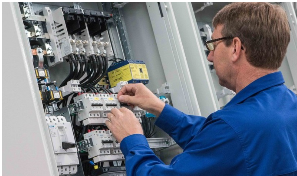
Рисунок 9 – Проверка и тестирование КРУ
