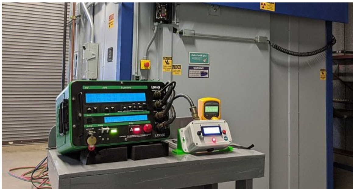
Рисунок 11 – Проверка рабочих характеристик оборудования электроустановки
