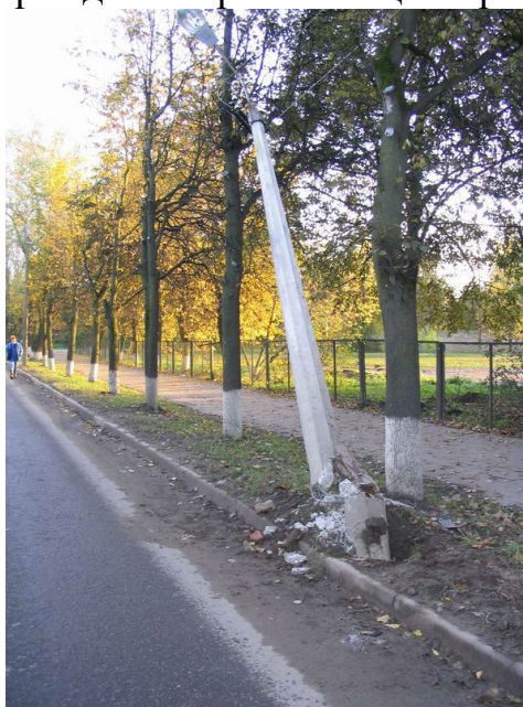
Рисунок 2 – Повреждение опоры автомобильным транспортом
